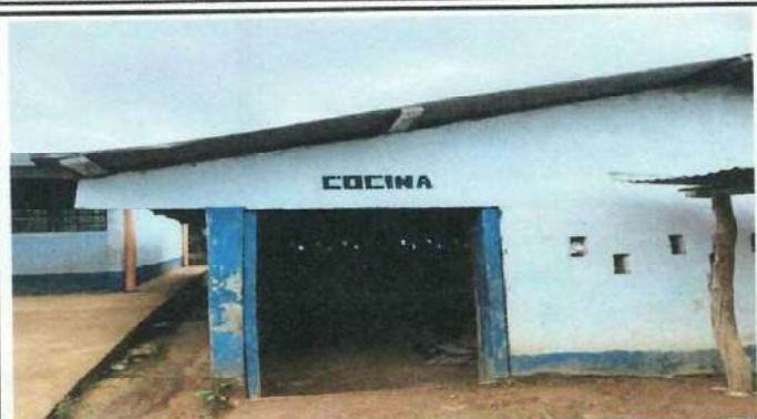
Foto 1: Puerta de la cocina improvisada de madera. Se requiere puerta metálica.
