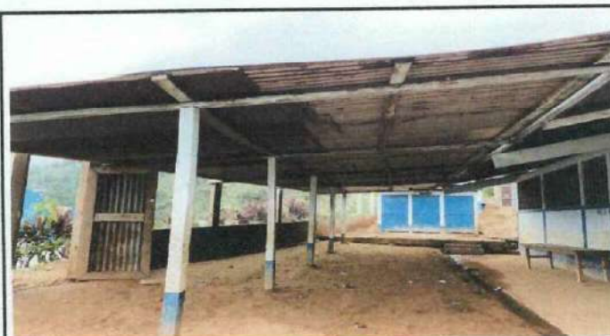
Foto 3: Puerta deteriorada y corredor en mal estado.
